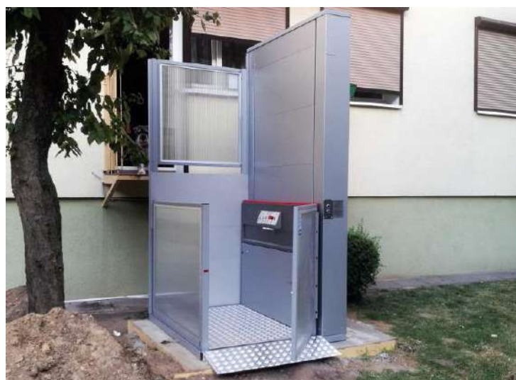
Podnośnik na dolnym przystanku w wersji przelotowej.
